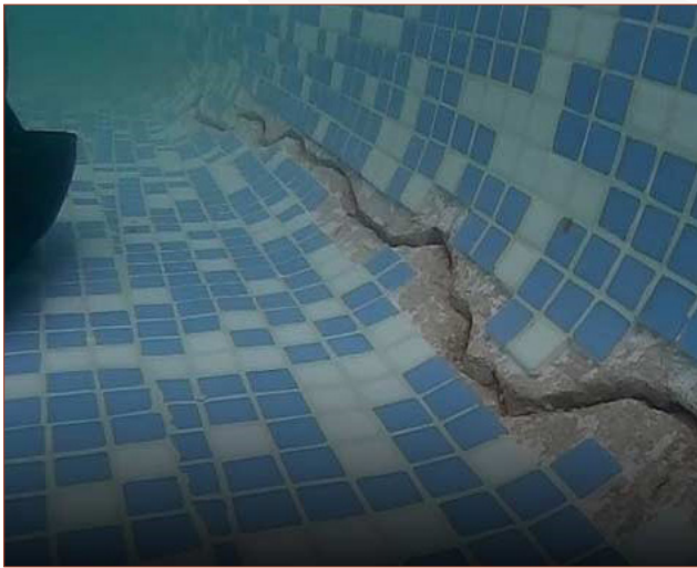
شکل ۲- ترک برداشتن دیواره استخر به علت عایق کاری نامناسب
