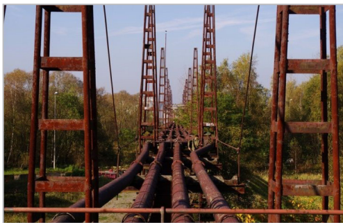
شکل ۳- خوردگی در لوله های نفت
