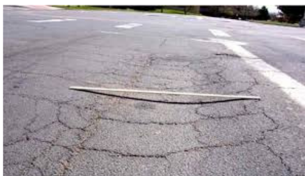
شکل ۱- شیارشدگی در سطح آسفالت
