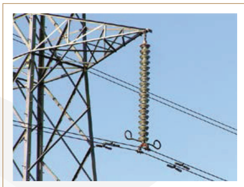
شکل ۱- نمایی از مقره در خطوط انتقال برق
