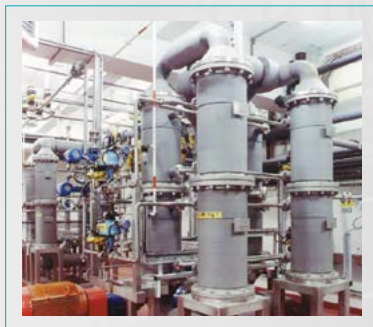
» شکل ۱۵. تجهیزات نانوفیلتراسیون بر مبنای غشاهای سرامیکی که توسط شرکت Mantec Technical Ceramics در یک کارخانه داروسازی نصب گردیده است [۲۳]
