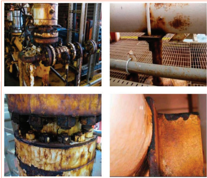
شکل ۱- نمونه‌هایی از خرابی حاصل از خوردگی
