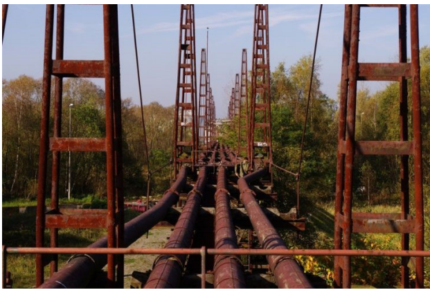
شکل ۳- خوردگی در لوله های نفت
