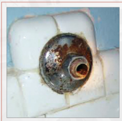
شکل ۲. خوردگی در لوله‌های آب گرم.
